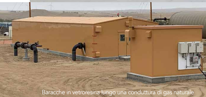
Stazione di analisi in pannelli di vetroresina all'interno di un petrolchimico
